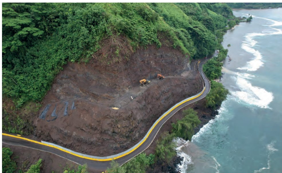
Travaux de sécurisation et de déblai la route de Hitia'a o te ra (Tahiti) suite à un éboulement, dû aux intempéries © Présidence de la Polynésie française
